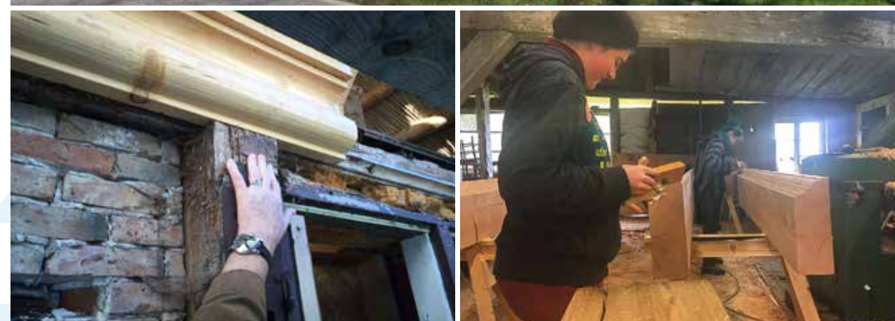
v.l.n.r. Hufnerhaus, 1950er Jahre, Hufnerhaus, August 2015, Fugenarbeit an der Südwand, Hufnerhaus November 2016, Probe Saumschwelle 2018, Arbeiten an der Saumschwelle 2018
